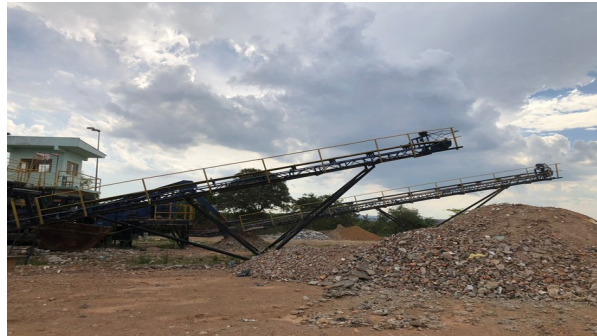
Figura 11 – Imagem do Sistema de Britagem para beneficiamento dos RCC
